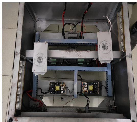
（AD 采样模块及数据处理系统，此为下部）
