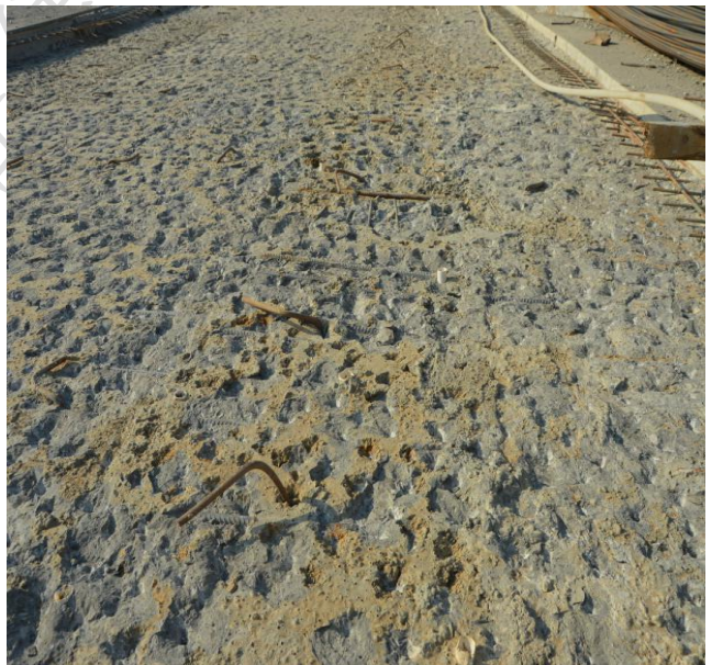
图 2 凿毛深度太深对梁体损坏
